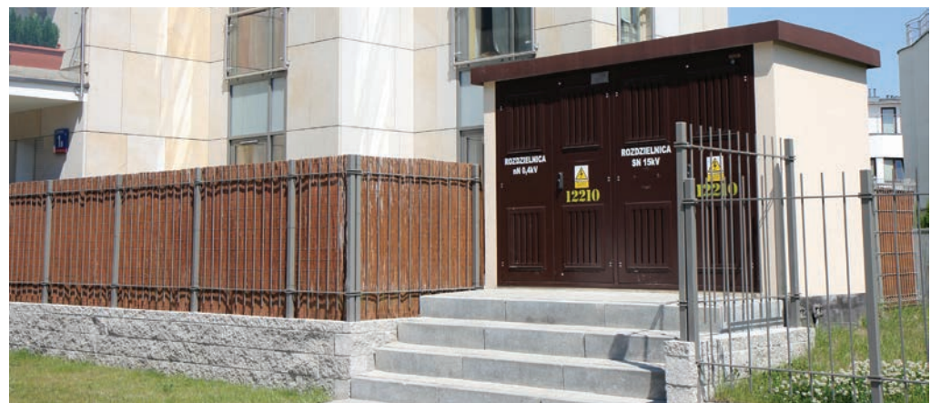
Inteligentna stacja transformatorowa typu Mzb1 na jednym z nowoczesnych osiedli w Warszawie
