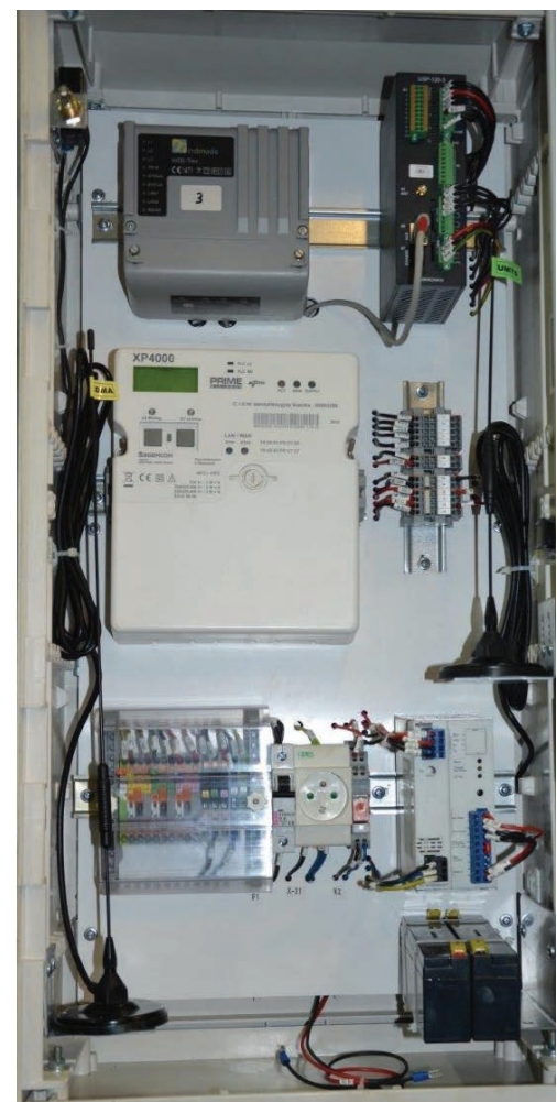
Widok szafy AMI wewnątrz
