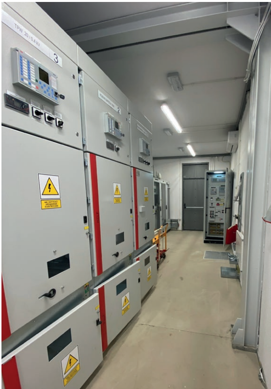
Rozdzielnica SN typu RELF, wykonana w klasie odporności na łuk elektryczny AFLR, co zapewnia bezpieczeństwo personelu obsługującego rozdzielnicę
