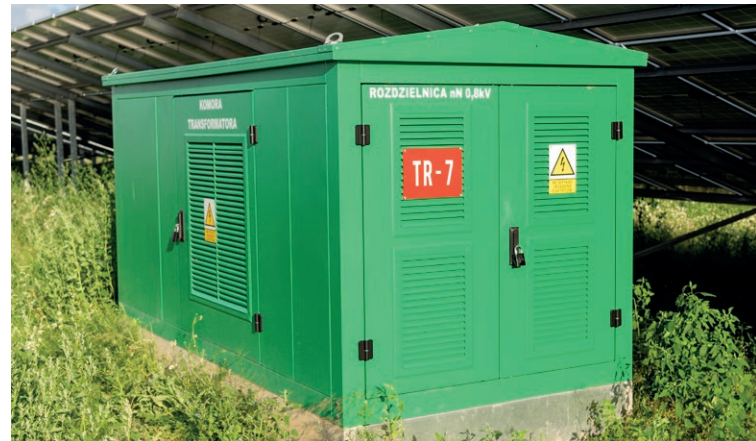
Jedna ze stacji w obudowie metalowej dostarczona na farmę fotowoltaiczną w gminie Postomino
