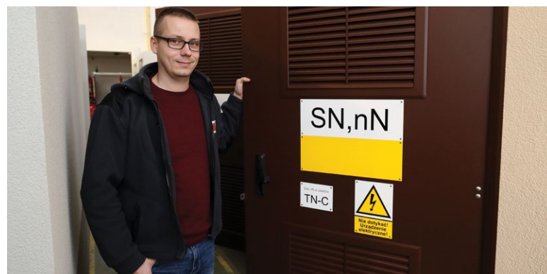
POWIETRZE PRZENIKA DO WNETRZA STACJI I Z POWROTEM PONAD DWA RAZY SZYBCIEJ. TERAZ ZAMIAST CZTERECH ŻALUZJI W STACJI MOŻEMY ZAMONTOWAĆ TYLKO DWIE.
