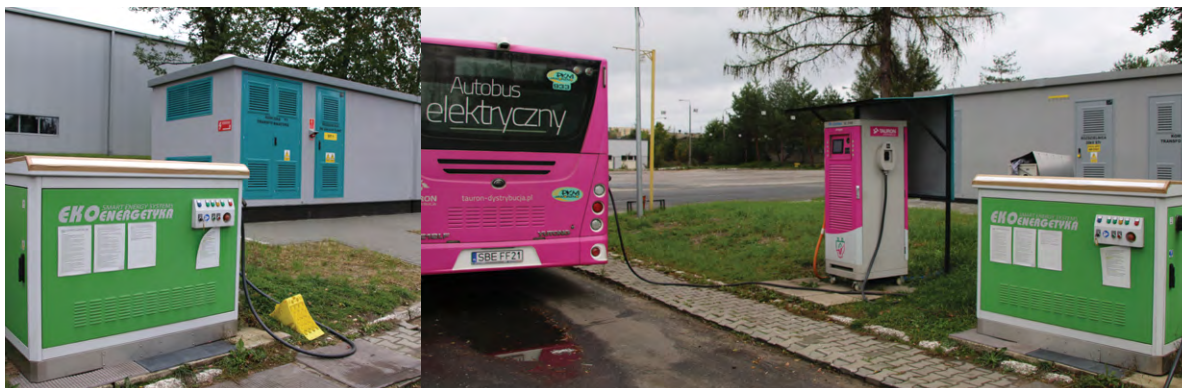
KONTENEROWE STACJE TRANSFORMATOROWE ZPUE S.A. USYTUOWANO POMIĘDZY ŁADOWARKAMI ZEWNĘTRZNYMI A HALĄ.
