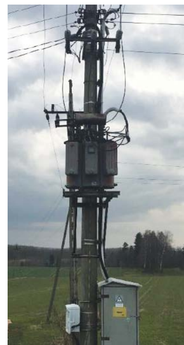
MONITORING ROZDZIELNICY STACYJNEJ STAREGO TYPU - WIDOK NA MONITOROWANĄ STACJĘ.
