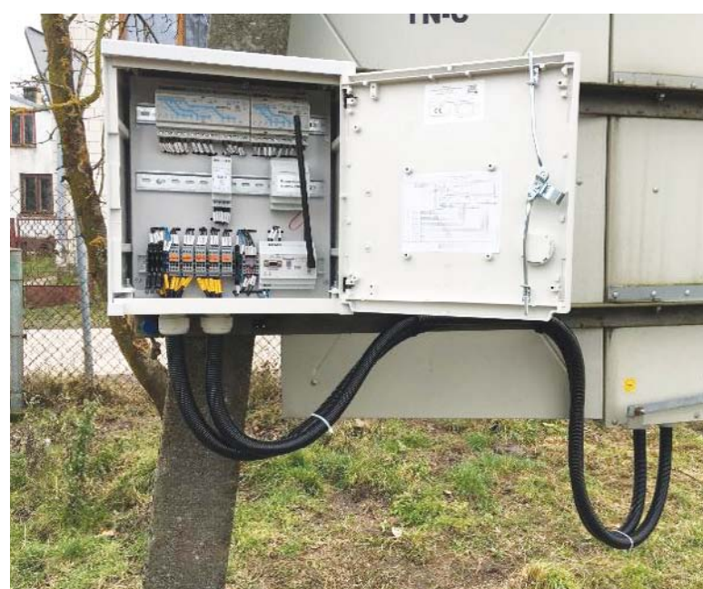
SZAFKA WSB0 MONITORUJĄCA ROZDZIELNICĘ nN TYPU RS-W
