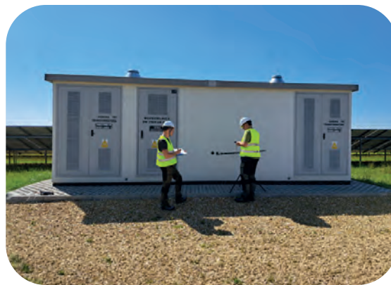
Rys. 10. Badanie emisji hałasu z dwoma transformatorami 1600 kVA.
