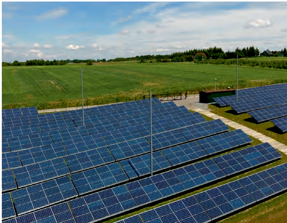
Farma fotowoltaiczna w Czańcu. Photovoltaic farm in Czaniec, Poland.
