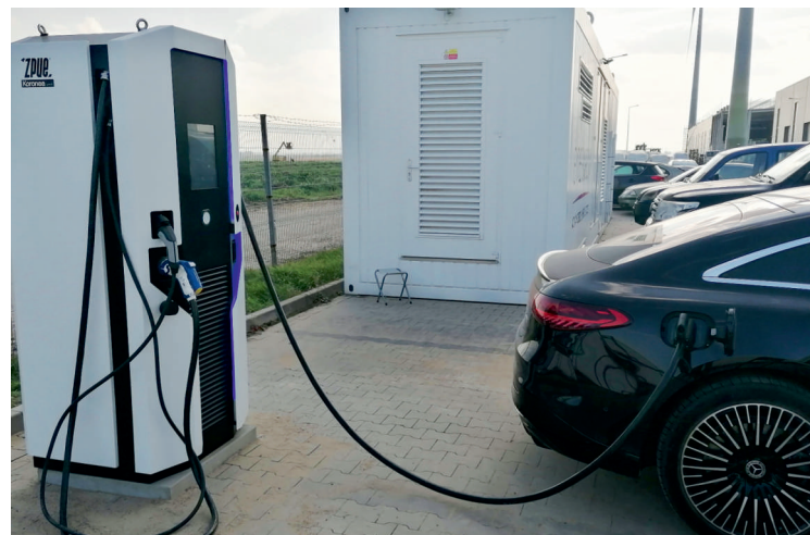
Stacja ładowania samochodów elektrycznych EV-C w Gaju Oławskim. EV-C electric vehicle charging station in Gaj Oławski.
