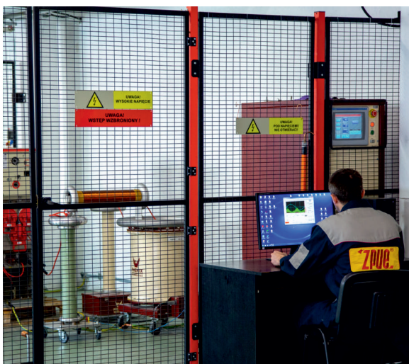
Stanowisko do prób napięciowych przy częstotliwości sieciowej oraz do badania poziomu wyładowań niezupełnych.
