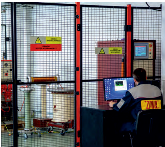
Stanowisko do prób napięciowych przy częstotliwości sieciowej oraz do badania poziomu wyładowań niezupełnych.
