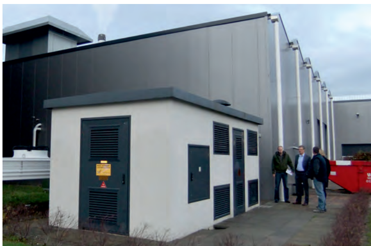
Stacje transformatorowe w obudowach betonowych zasilające szklarnie w Holandii. Transformer stations in concrete housings powering greenhouses in the Netherlands.
