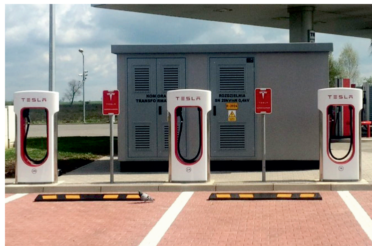
Super ładowarki TESLA na stacji benzynowej. Tesla superchargers at oil station.
