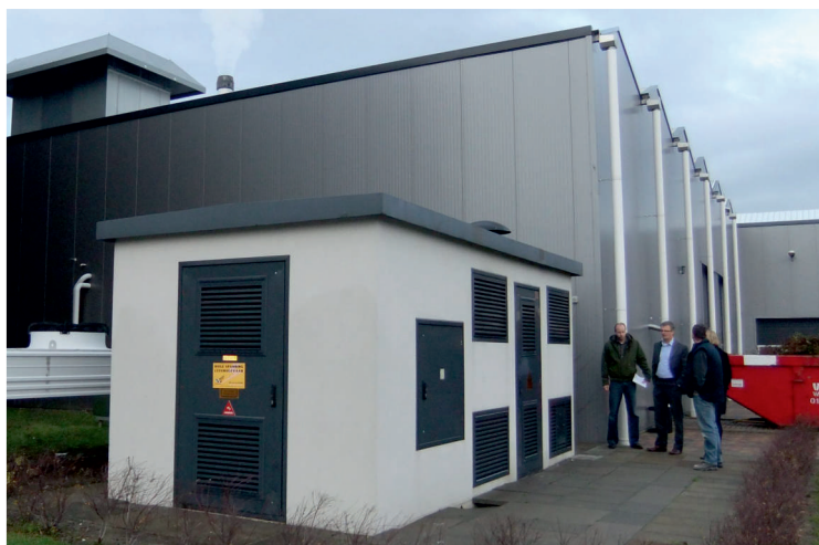
Stacje transformatorowe w obudowach betonowych zasilające szklarnie w Holandii. Transformer stations in concrete housings powering greenhouses in the Netherlands.
