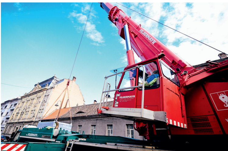
Podziemna stacja transformatorowa w historycznej części Sybiu w Rumunii. An underground transformer station in the historic part of Sibiu, Romania.
