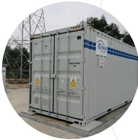
5 różnych technologii dostosowanych do magazynów energii dla Enea Operator.
