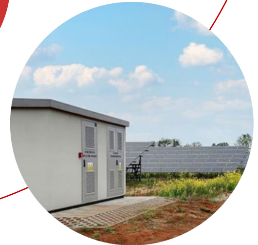
Dostarczyliśmy 9 stacji transformatorowych na farmie w Januszkowicach.
