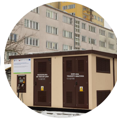
Realizacja magazynu energii wyposażonego w stację do ładowania samochodów elektrycznych dla innogy – Warszawa.
