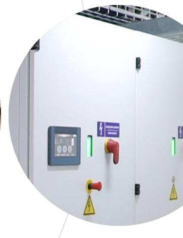
Zestawy baterii w podziemnej części magazynu w Piekarni Inter Europol – Małopole.
