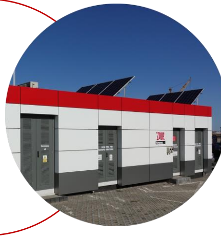
Magazyn energii zlokalizowany w inteligentnej stacji SPS przy siedzibie ZPUE S.A. we Włoszczowie.
