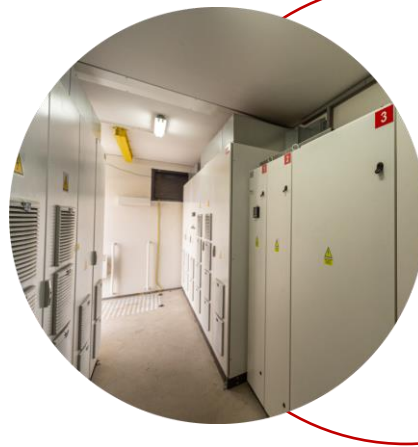
Część naziemna magazynu energii w Piekarni Inter Europol – Małopole.
