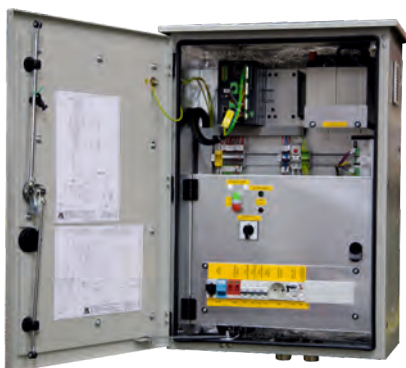
Szafa obiektowa S01-THO-T1 ze sterownikiem SO-54SR-3xx
