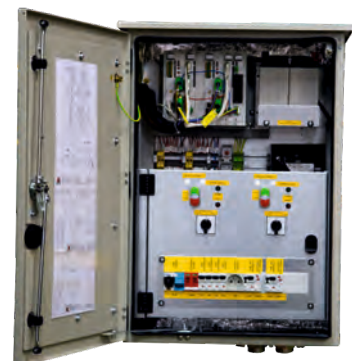
Szafa obiektowa S01_2-THO-T1 ze sterownikiem SO-54SR-4xx
