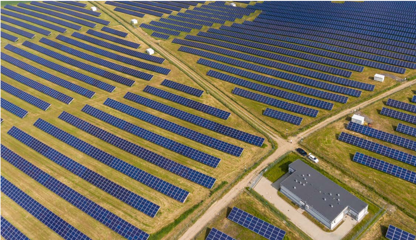
72 stacje o mocy 1 MW wyposażone w rozdzielnice SN oraz nN produkcji ZPUE S.A.
