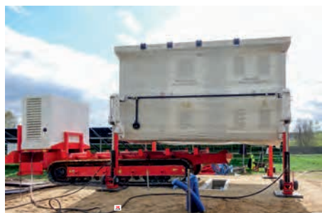
Stacja na podnośnikach, wyjazd platformą
