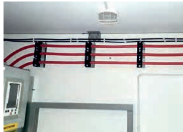
Połączenia kablowe SN
