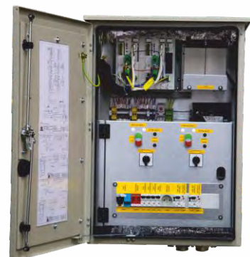
Szafa obiektowa S01_2-THO-T1 ze sterownikiem SO-54SR-4xx
