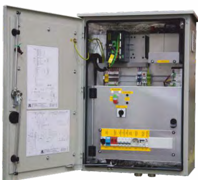
Szafa obiektowa S01-THO-T1 ze sterownikiem SO-54SR-3xx
