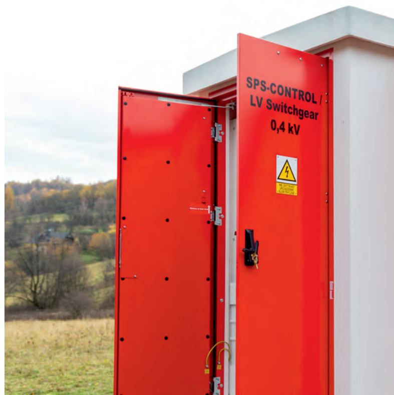
Magazyn energii produkcji ZPUE o mocy 100 kW i pojemności 187 kWh
