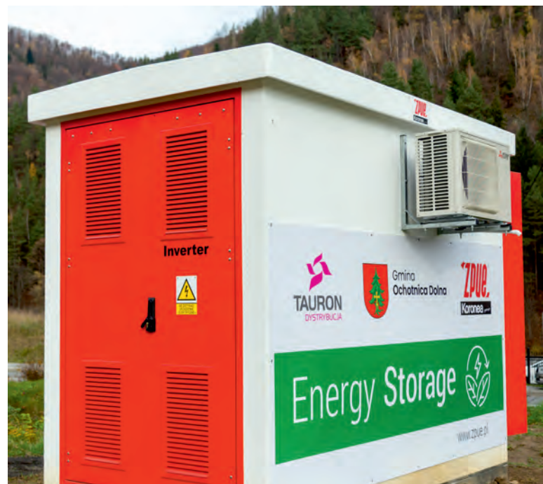
Gmina Ochotnica Dolna postawiła na magazynowanie energii
