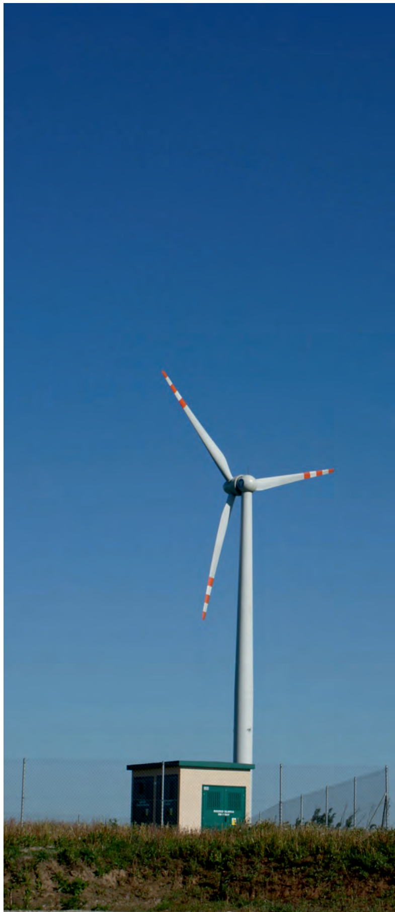
Do farm wiatrowych zamawiane są w ZPUE zestawy: Główny Punkt Odbioru, misy olejowe oraz stacje do kompensacji mocy biernej
