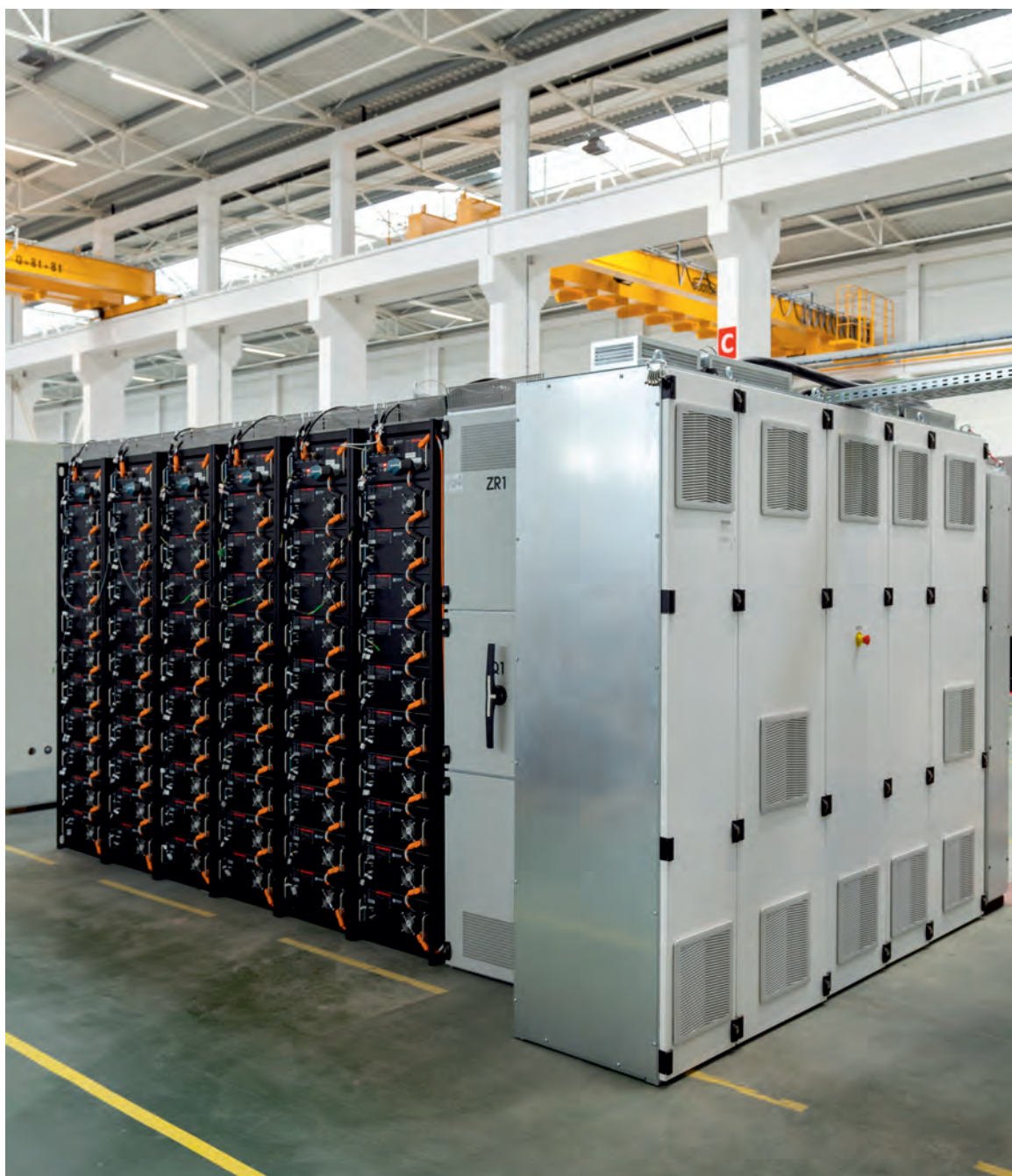
Magazyn energii typu MEW-w dostarczony przez ZPUE dla firmy Maersk dysponuje mocą 400kW i pojemnością 1065kWh
