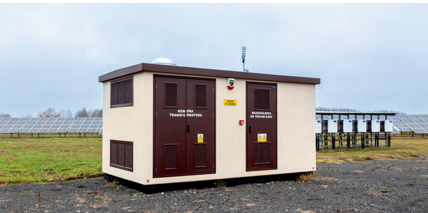
Inwestycja zrealizowana przez ZPUE dla farmy PV w Jasiercu: stacja o mocy 1 MW oraz magazyn energii
